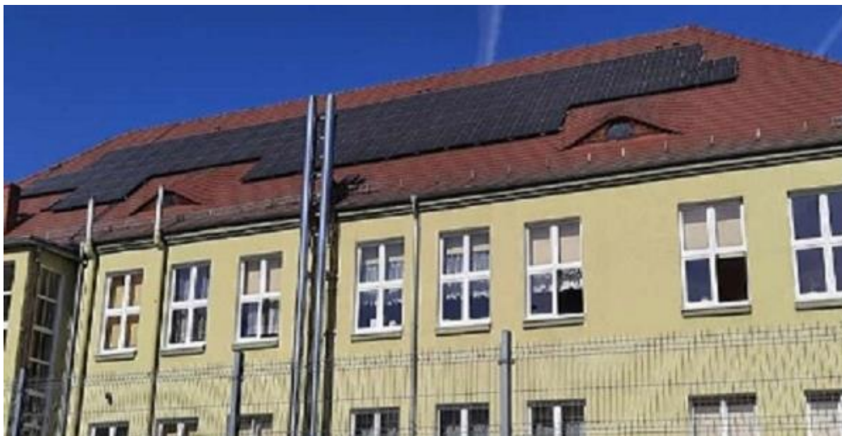
Zdjęcia: Szkoła Podstawowa im. Marii Konopnickiej w Kostomłotach – instalacja fotowoltaiczna
