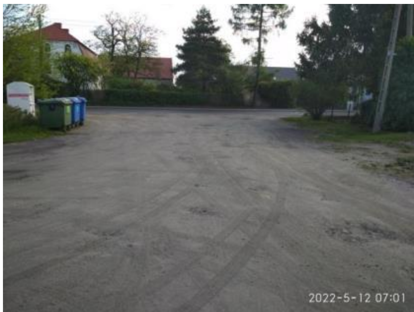
Zdjęcie: droga w miejscowości Piersno przed przebudową z placem manewrowym
